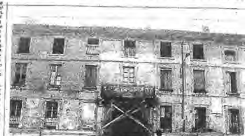
La facciata fatiscente della villa Citadini-Stampa, che sorge a Castelello di Abbiategrasso. Per evitare crolli è stato puntellato il balcone sopra il grande portale.
